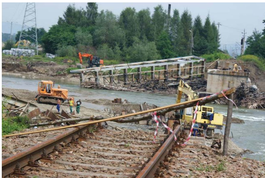
Katastrofa mostu kolejowego nad rzeką Poprad
