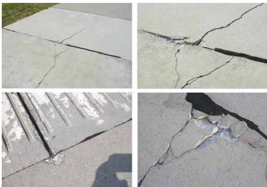
Rys. 1. Uszkodzenia płyt przy punktowym docisku (efekt koncentracji naprężeń)
