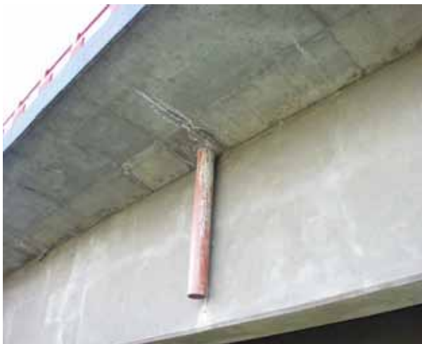
Fot. 5. Wadliwie zaprojektowane odwodnienie mostu
