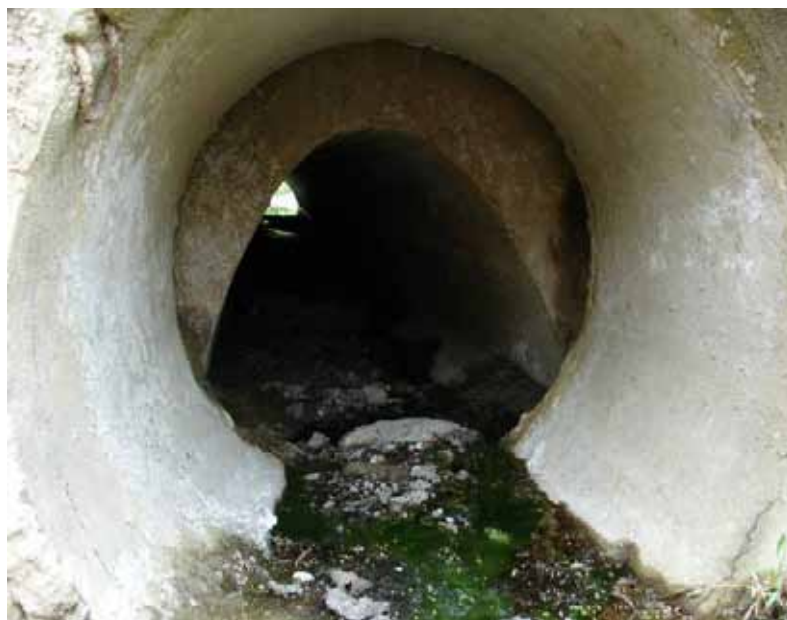
Fot. 14. Wnętrze przepustu o zwężonym świetle przez sklawiszowane elementy prefabrykowane
