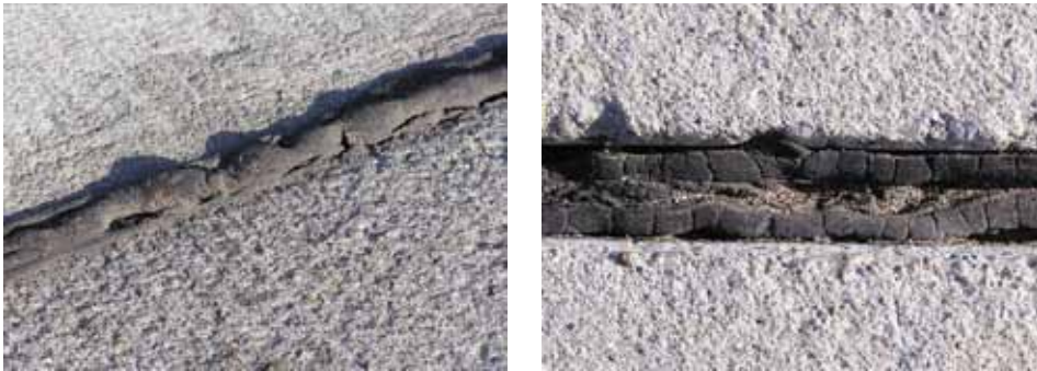
Rys. 5. Zdegradowana masa bitumiczna po kilkuletniej eksploatacji pod wpływem oddziaływania termicznego i mechanicznego (przemieszczaniem się płyt betonowych)
