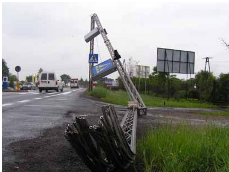
Fot. 11. Konstrukcja bramowa uderzona przez pojazd ochroniła kierowcę przed tragicznymi skutkami wypadku - dzięki niewielkiej wadze konstrukcji aluminiowej ruch został udroźniony w przeciągu kilku minut bez używania ciężkiego sprzętu (konstrukcja została przeniesiona na pobocze)
