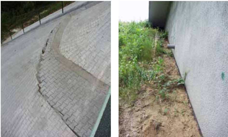
Fot. 8, 9. Przykłady niewłaściwego zabezpieczenia skarp nasypów przy przyczółkach
