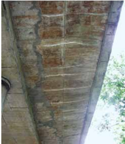
Fot. 4. Przykład nieodpowiedniego ukształtowania elementów obiektu mostowego
