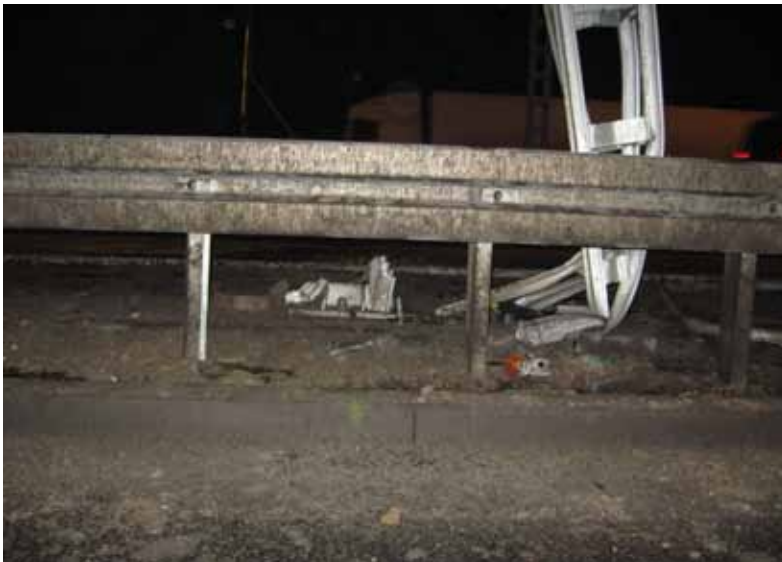
Fot. 10. Słup konstrukcji wsporczej bramowej wykonanej w systemie PRO-LIFE dał szansę przeżycia kierowcy w tym wypadku
