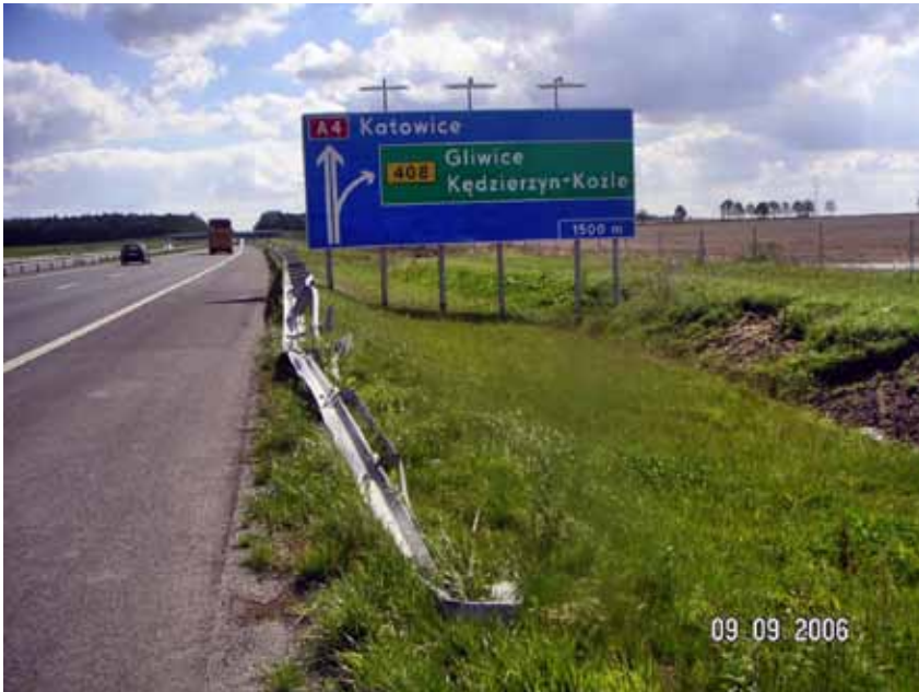
Fot. 1. Skutki najechania pojazdu na odcinek początkowy drogowej bariery ochronnej
