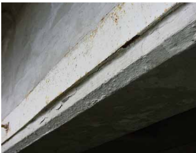
Fot. 10, 11. Przykłady błędów robót remontowych
