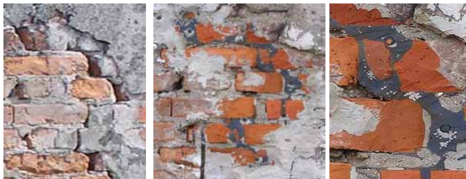
Rys. 2. Polimerowe złącze podatne wykształcone w pękniętej konstrukcji murowej
