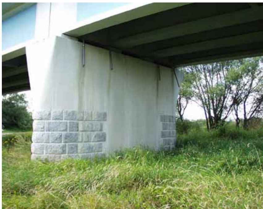
Fot. 6. Wadliwe zaprojektowanie odwodnienie mostu
