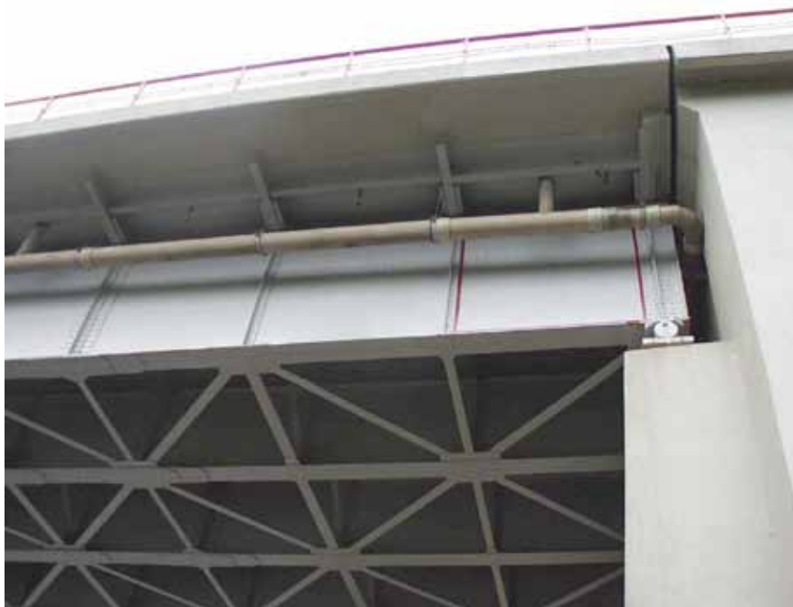
Fot. 7. Wadliwe podparcie skrajnego dźwigara
