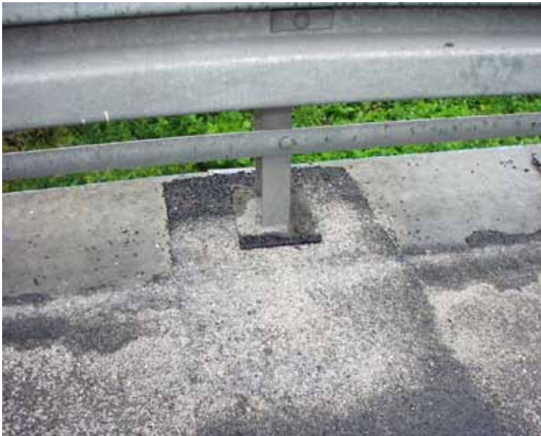
Fot. 12, 13. Niewłaściwie zaprojektowane i wykonane krawężniki, nawierzchnie jezdni i chodników oraz bariery ochronne i balustrady
