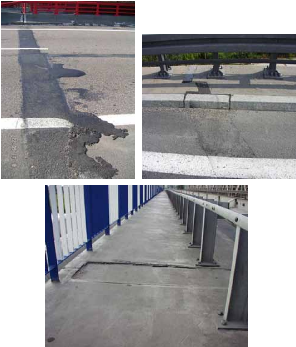
Fot. 1 – 3. Przykłady uszkodzeń obiektów mostowych spowodowanych błędami projektowymi i wykonawczymi
