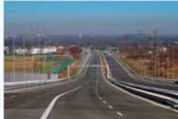
Percepcja widoku drogi S7 widziana od węzła Kraków-Bezrzeczka kierunku węzła Kraków-Rybnica View from Kraków-Bezrzeczka road junction towards Kraków Railway road junction
